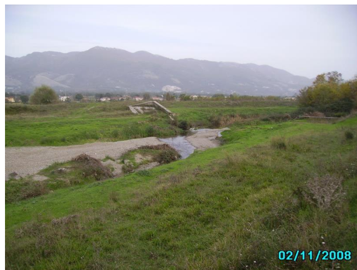
Briglia sifonata con materiale depositato a valle della stessa
